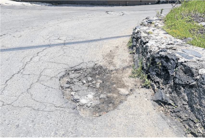
Bache localizado en San Andrés Totaltepec, en la alcaldía Tlalpan, donde los vecinos dicen que ya llevan tres meses denunciando varias oquedades.
